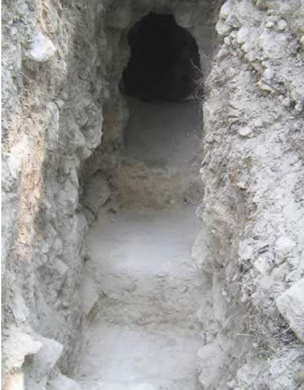
Figura 41b. Banca y muro destruido por saqueo.
