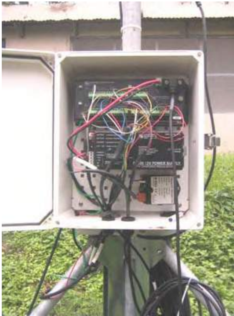
Figura 15. Interior del Datalogger CR10X.
